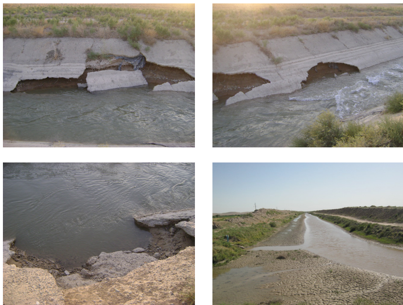
Рисунок 2.4. Техническое состояния канала
