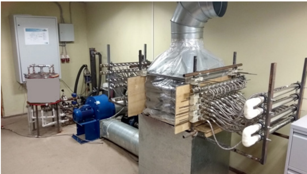
Abbildung 6. Zweikreis-Prüfstand nach der Modernisierung
